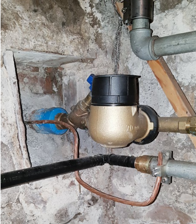
Ersatzerdung an Wasserleitung nach Ersatz der Hausanschlussleitung
